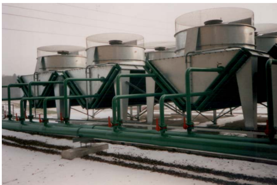
Refroidisseurs à double bloc ECODYNE AG avec six ventilateurs à pales pour turbine à gaz ABB
