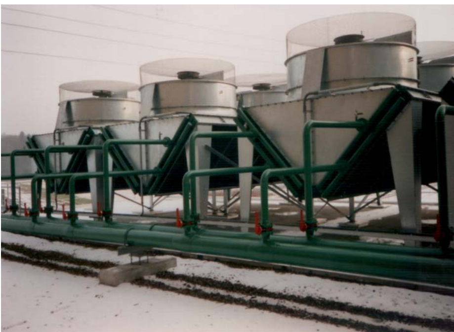
Scambiatori di calore ECODYNE AG con 6 ventilatori per turbine a gas ABB
